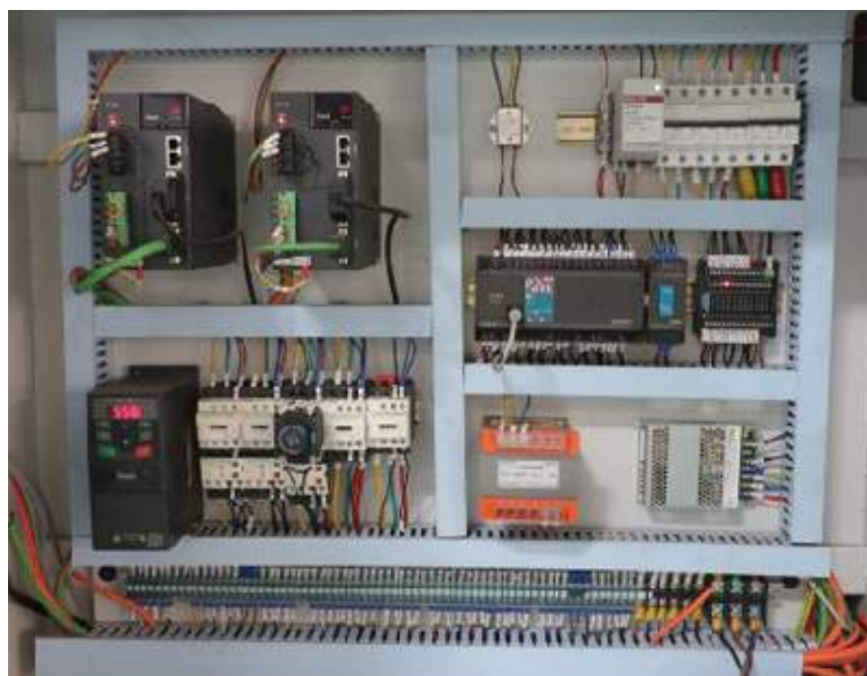
Tủ điện linh kiện cao cấp
