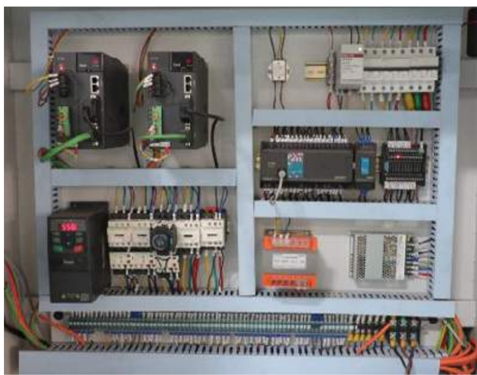
Tủ điện linh kiện cao cấp
