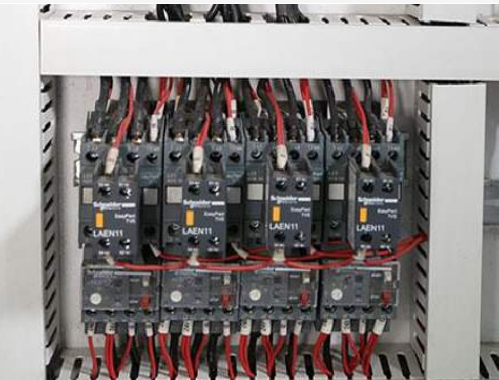
Hệ thống tủ điện: Scheider Pháp
