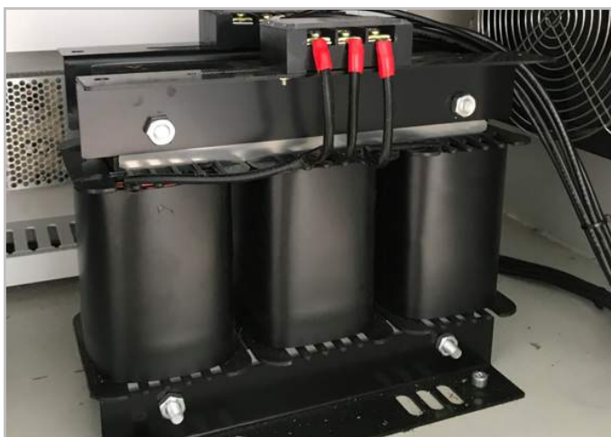
Biến áp bảo vệ máy
